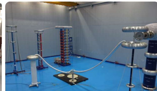
900 kV AC/2400 kVp UHV EM shielded Test Lab
