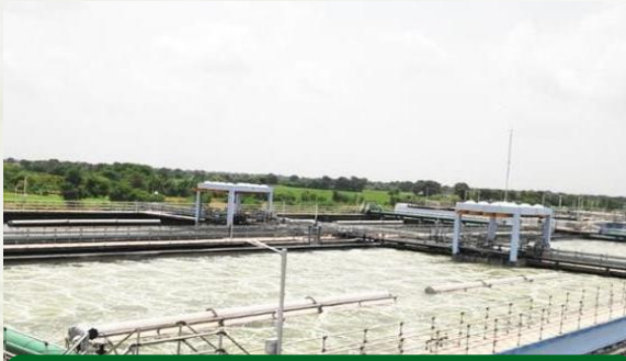
32 MLD STP Botad Gujarat
