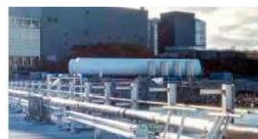
1,000 m3 Mini LNG Terminal
