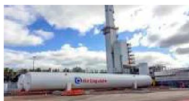
300 KL and 500 KL tanks
