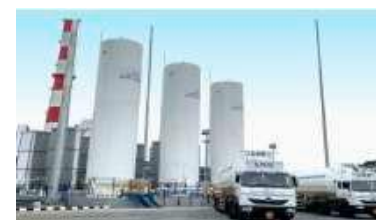
LNG satellite station
